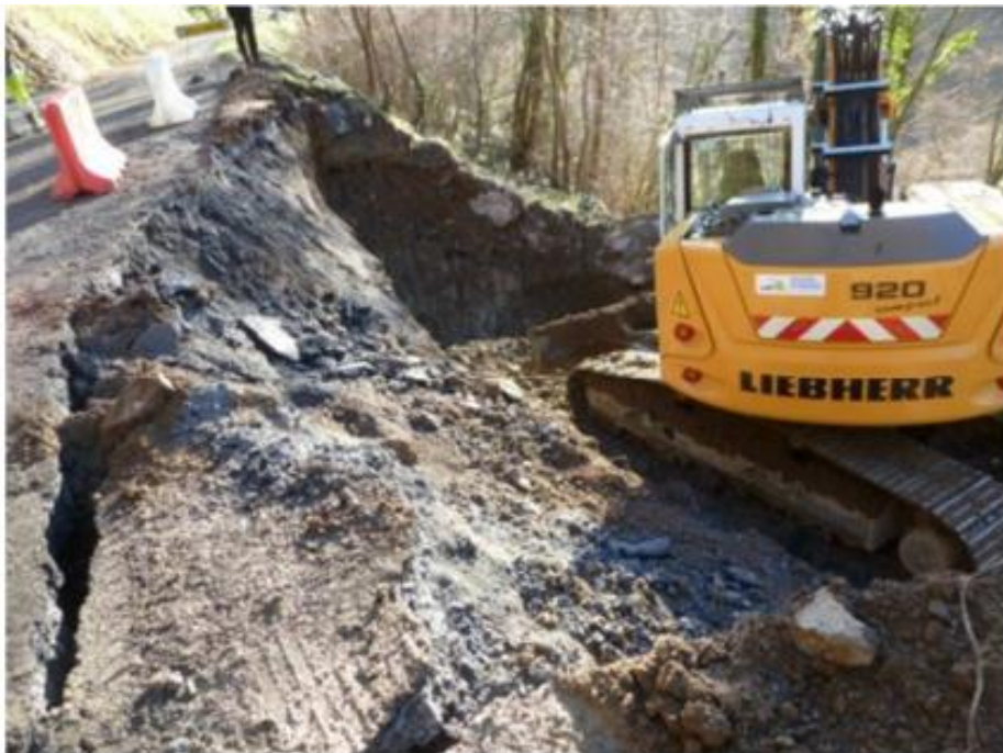
Crue du 13 décembre 2019 Arrodets-ez-Angles
