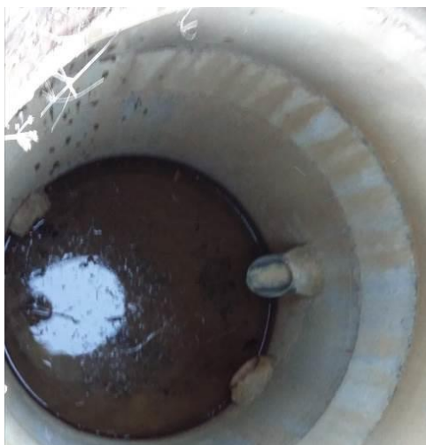
Exemple d'un puits de drainage (PD10)
