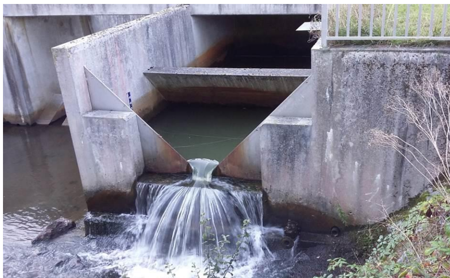
Bassin et seuil de restitution
