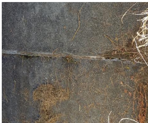
Couvre-joint abîmé (dernier joint coursier avant bassin de dissipation)
