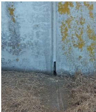
Couvre-joint abîmé (aval passerelle RG)
