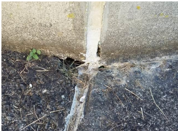
Erosion bajoyer entonnement RD
