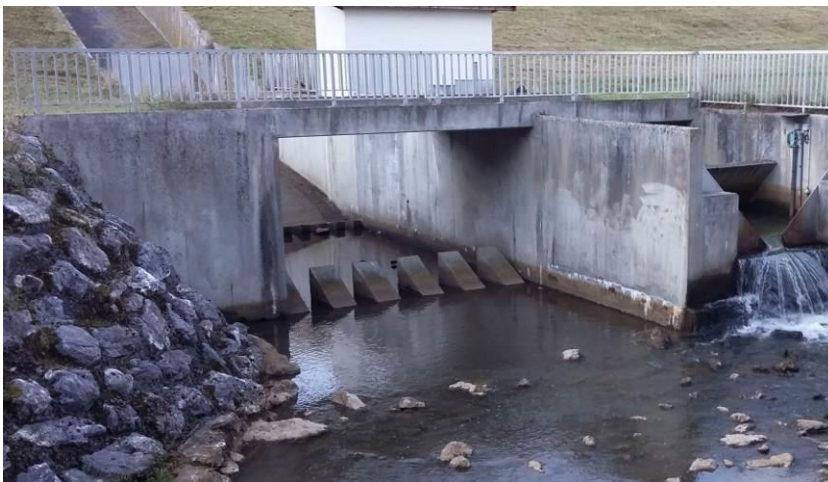
Bassin de dissipation
